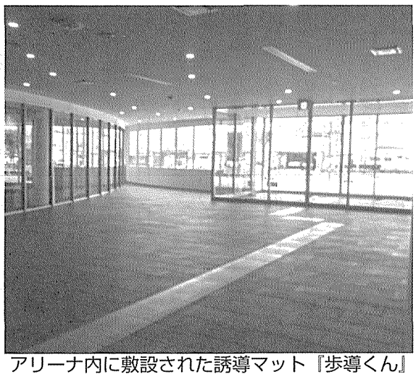
アリーナ内に敷設された誘導マット「歩導くん」
