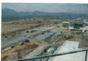
▲ターミナルビル前の道路・駐車場の工事は開港直前まで続く
