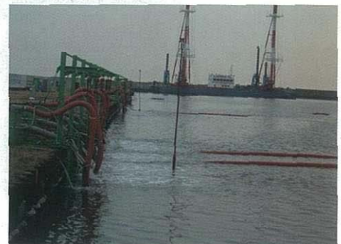
口絵写真—27 ポンプ運転状況
